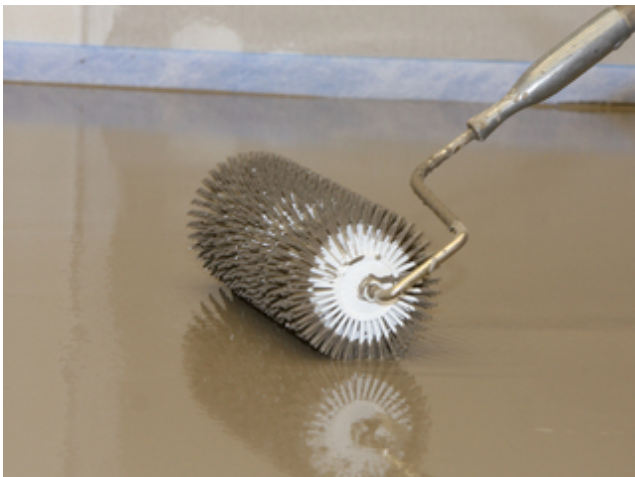
9. Zur Entlüftung eingeschlossener Luftblasen kann die Spachtelmasse mit einer Stachelwalze durchgerollt werden.
