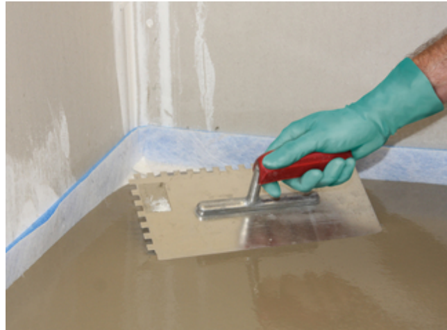
8. Mit einer Glättkelle oder einem Raket kann der Sopro FaserFließspachtel gleichmäßig verteilt werden.
