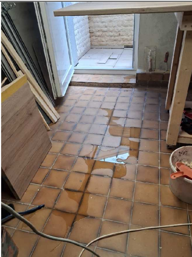
Bild 19: Wassereintritt in Kellerraum
