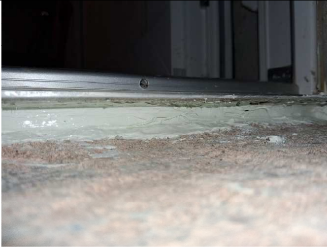
Bild 25: Abdichtung unterhalb Kellertür (rechts, von außen)
