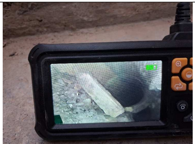
Bild 12: Tonleitung von innen (wurde später beräumt)
