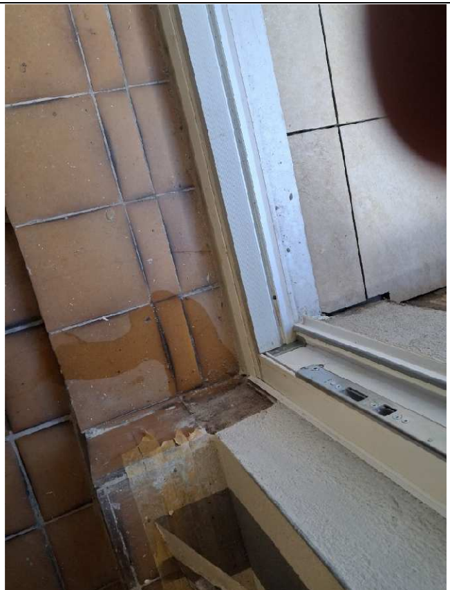
Bild 20: Feuchte Stelle in Wand rechts der Kellertür
