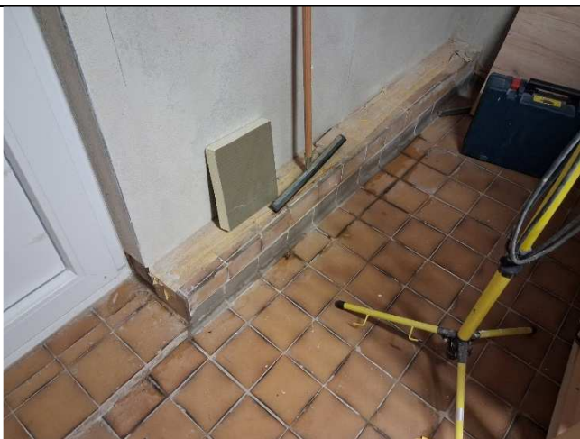
Bild 23: Reste von Wassereintritt
