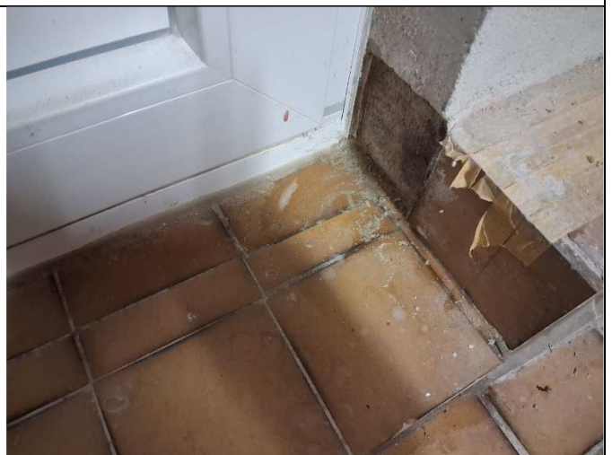
Bild 24: feuchte Wand rechts der Kellertür
