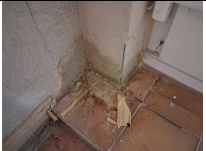
Bild 22: feuchte Stelle links der Kellertür
