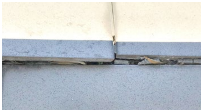
Abplatzungen im Randbereich eines Balkons
